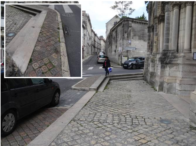
Actuel parvis. Espace très étroit, peu sécurisant pour le piéton, constitué de matériaux hétérogènes (pavés calcaire, pavés napoléoniens et granit, carreaux de terre cuite, emmarchement et bordure arasée en calcaire)
